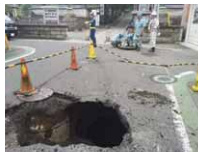
【管きょ老朽化に起因する道路陥没】 遊行寺前 2016(平成28)年9月
