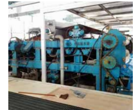
辻堂浄化センター だっすいき (ベルトプレス脱水機)
