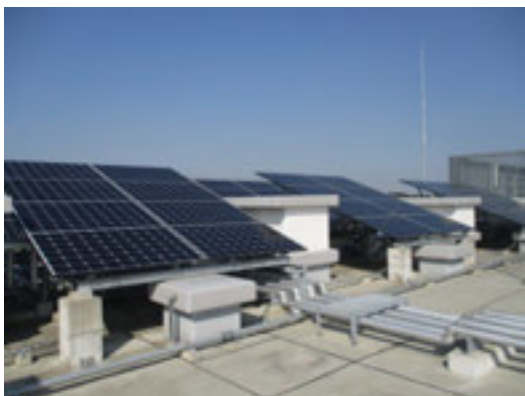
◆藤沢市民病院に導入した太陽光発電システム
