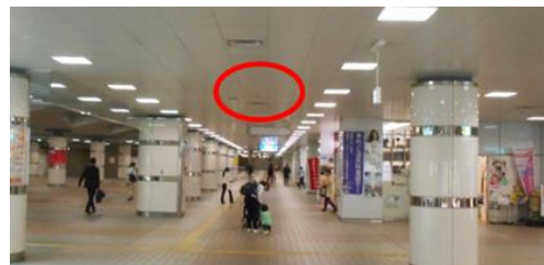
湘南台駅地下自由通路 設置箇所イメージ (前年度の防犯対策強化事業費から分離した事業) (この事業は平成29年度9月補正で実施した事業)
